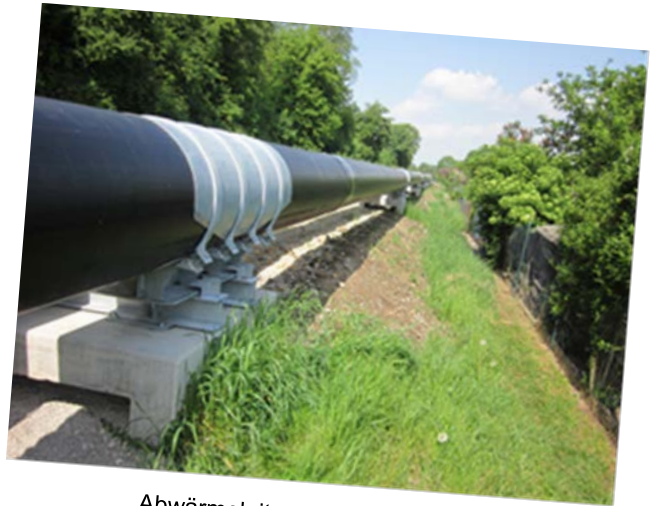
Abwärmeleitung von der Gunvor
