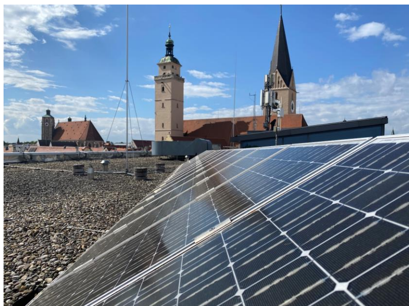
Photovoltaik-Anlagen auf städtischen Liegenschaften ©Stadt Ingolstadt
