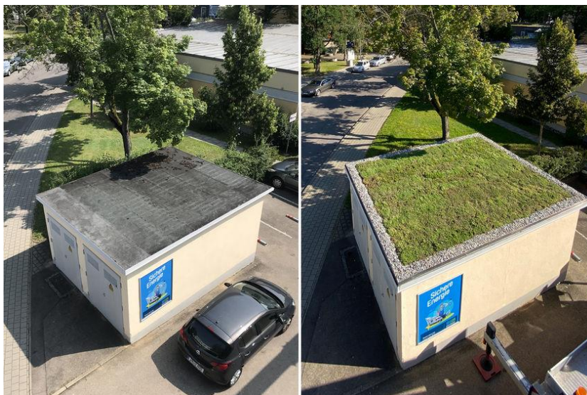
Dachbegrünungen auf den Trafostationen der Stadtwerke Ingolstadt ©Stadt Ingolstadt
