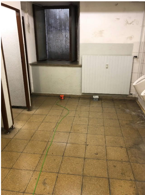
Foto 2: MP-2 im Keller
