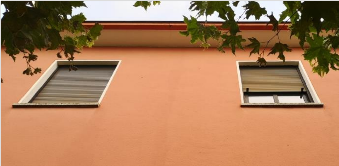
Abb.3: Fenster mit Jalousie im 1. OG.
