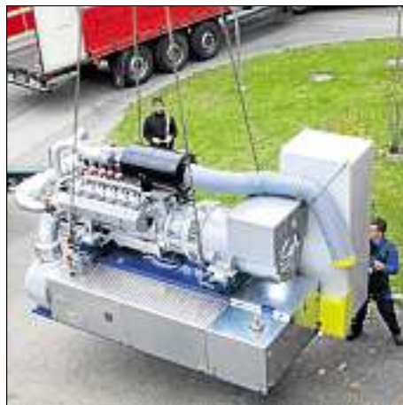
Energie aus Abwasser: Die ZKA investiert beständig in moderne Technik wie etwa die Energieerzeugung aus Faulgas – hier ein moderner Gasmotor.
