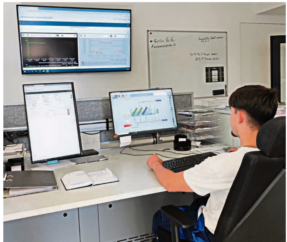
In der Messwarte steuert Dennis Drotleff die Reinigungsprozesse der Kläranlage.
