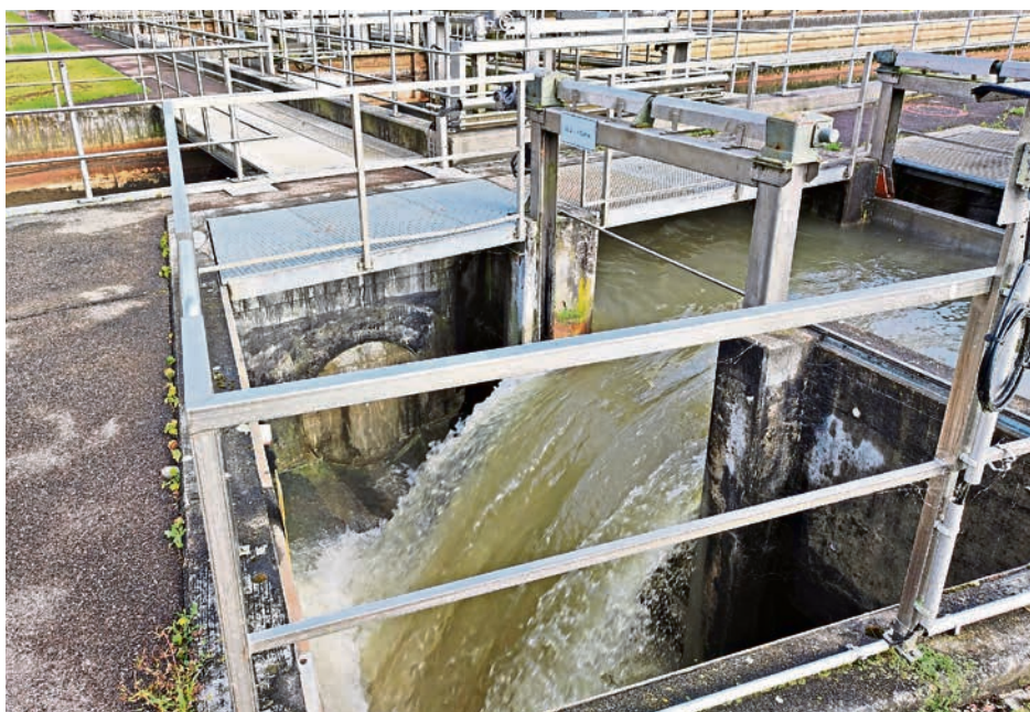
Notauslass bei Notbetrieb während des Donauhochwassers zur Druckentlastung des Donaudamms.
