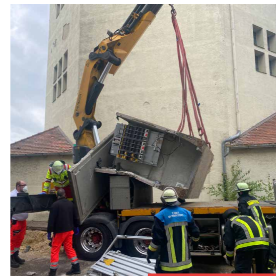
KRANUNFALL IN DER FRIEDRICH-EBERT-STRASSE 06.05.2022
