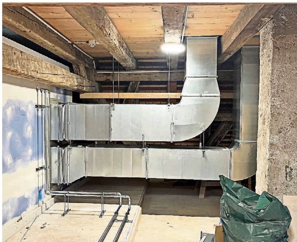
Die Lüftungsanlage der Kapelle.
