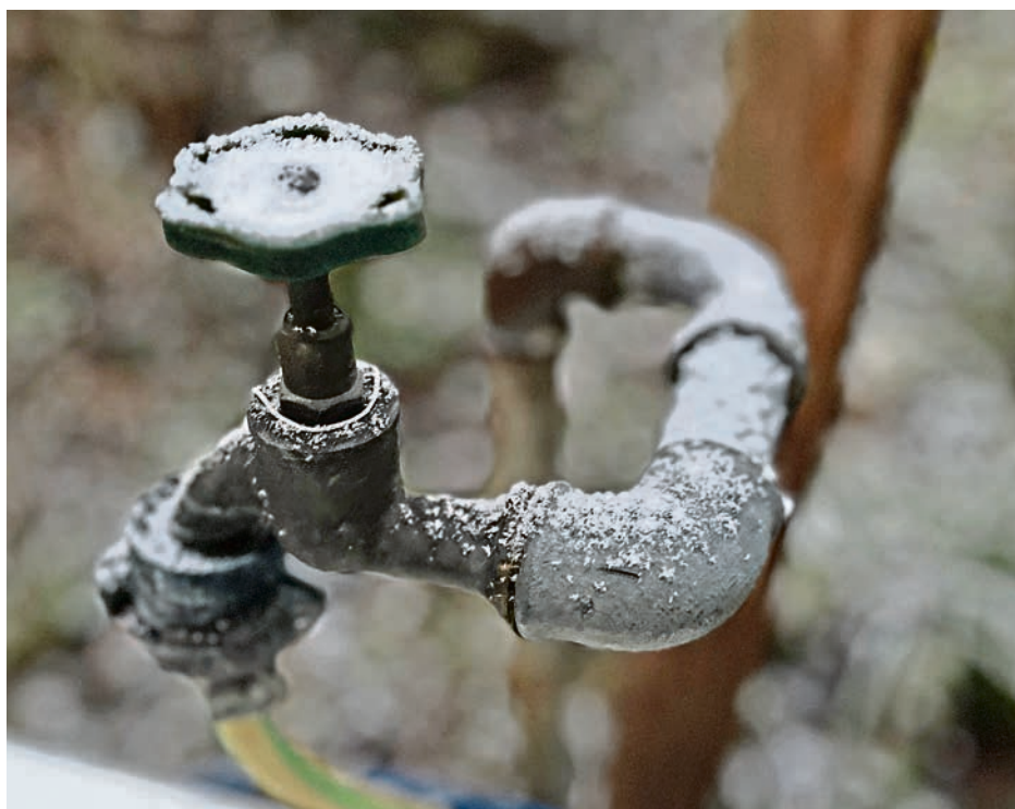
Frostgefährdete Wasserleitungen, wie etwa die Ventile der Außenanschlüsse, sollte man im Winter vorsichtshalber sperren und entleeren, raten die Ingolstädter Kommunalbetriebe.
