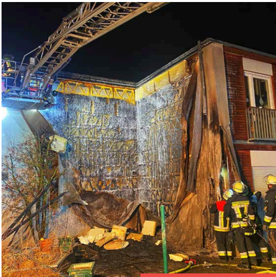
FASSADENBRAND AN ALTENHEIM 18.02.2023
