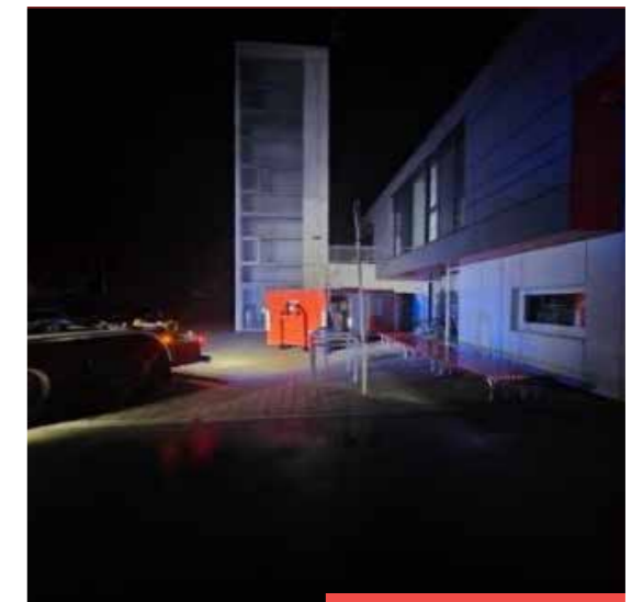
NOTSTROMVERSORGUNG FEUERWEHR- GERÄTEHAUS MÜNCHSMÜNSTER
