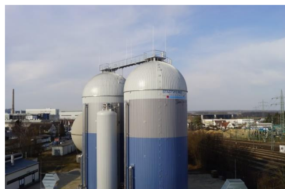
Wärmespeicher an der Ringlerstraße
